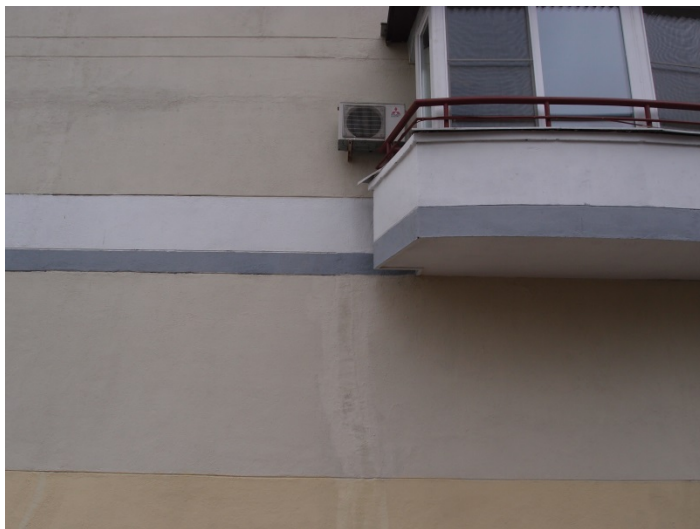
Ф.13. Непрокрасы фасадов, неровности штукатурного слоя.
