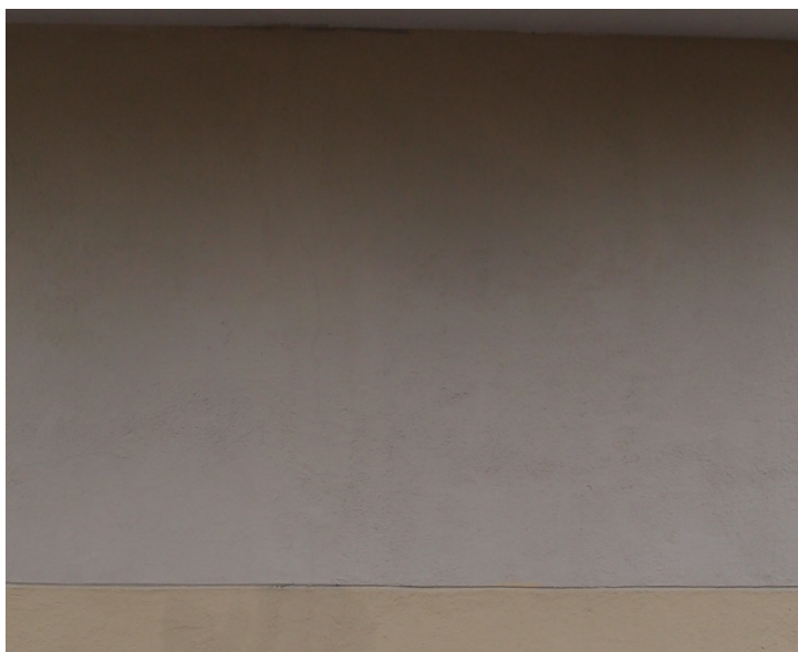
Ф.15. Волосные трещины в штукатурном слое.
