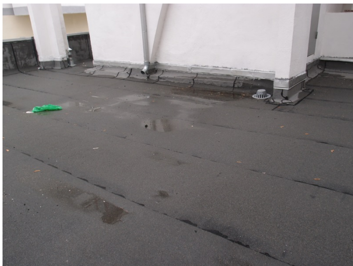
Ф.1 застойные зоны воды на кровельном покрытии,
