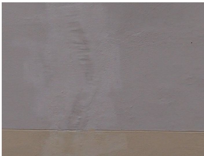
Ф.14. Неровности штукатурного слоя.
