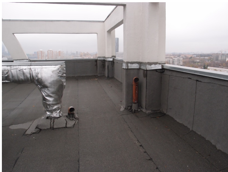
Ф.5. Флюгарки и защитные зонты, на вытяжках канализационных стояков отсутствуют
