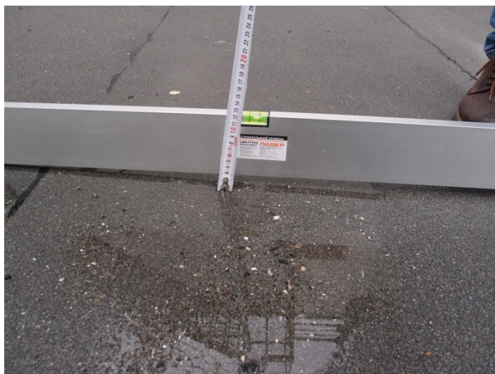
Ф.2 неровности кровельного покрытия превышающие нормативные значения,
