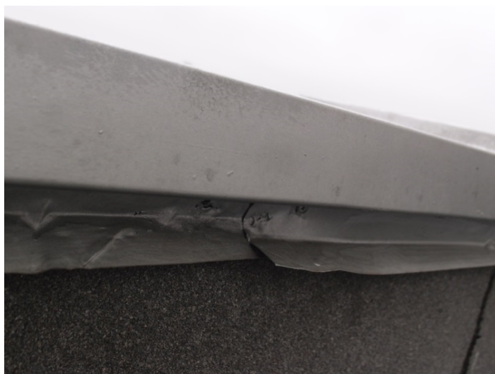
Ф.4. Окрытие парапета в ходе капитального ремонта не менялось под покрытием, на отдельных местах, установлены металлические отливы.
