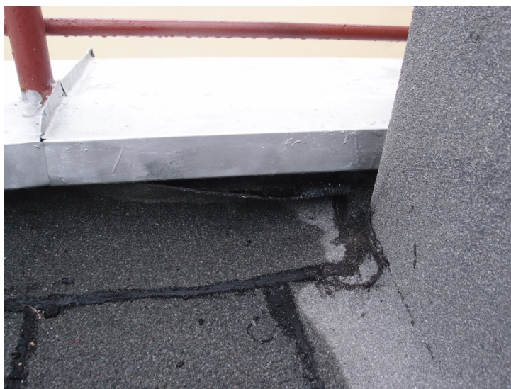
Ф.4 Нарушения в примыканиях гидроизоляции к парапетам.
