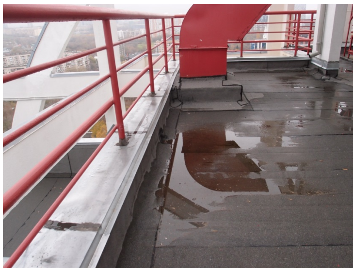
Ф.6. Нарушение разуклонки кровли
