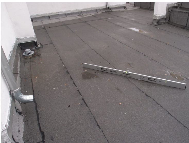
Ф.3 нарушения разуклонки к водосточным воронкам, вздутия.
