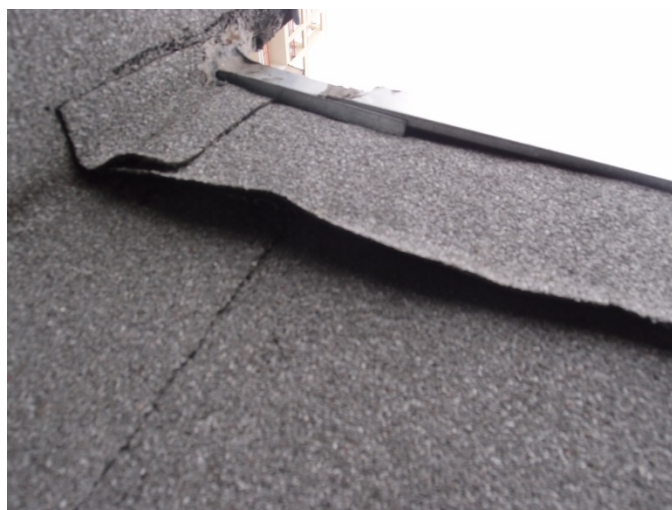
Ф.2 Слабое сцепление гидроизоляции с основанием.
