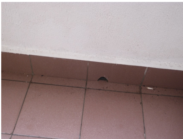
Ф.11. отверстия под водосточные воронки расширены.
