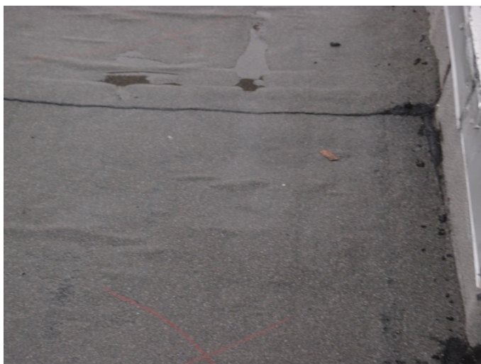
Ф.2. Вздутия, складки на поверхности гидроизоляционного ковра
