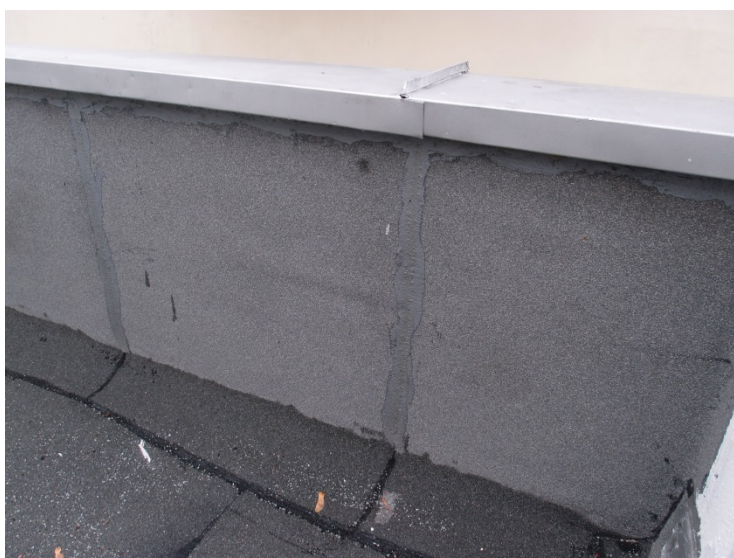
Ф.5 стыки гидроизоляционных слоев дополнительно уплотнены герметиком. Капельники отсутствуют.
