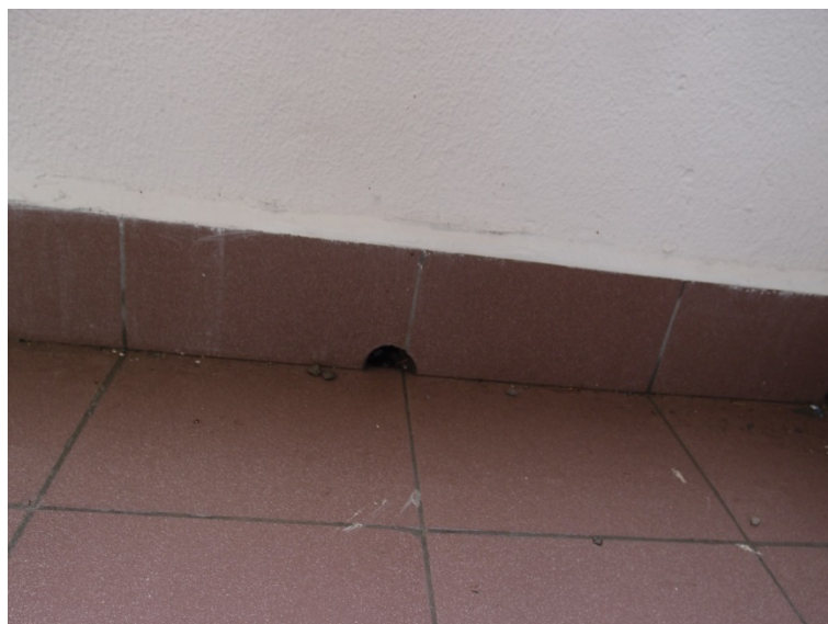
Ф.10. отверстия под водосточные воронки расширены.
