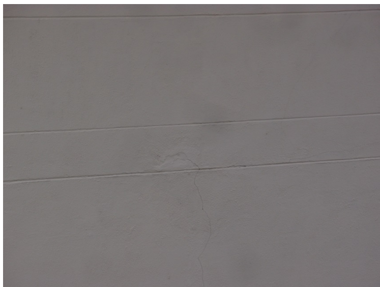
Ф.13 Неровности, трещины в штукатурке
