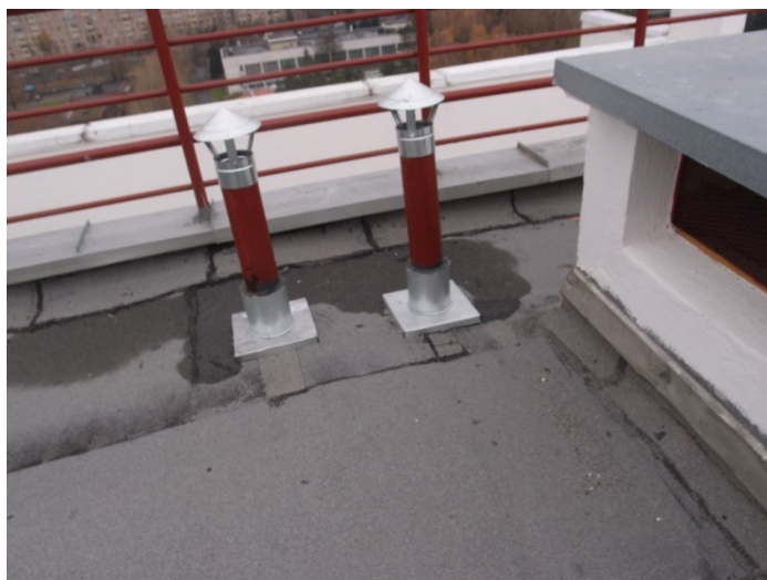
Ф.5. На вытяжках канализационных стояков установлены защитные зонты и флюгарки.
