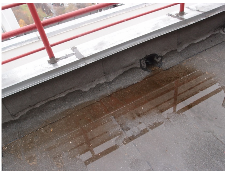
Ф.7. Водоотводящий лоток расположен выше уровня кровельного покрытия.
