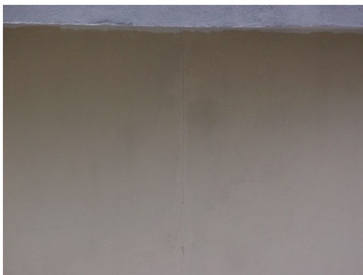
Ф.14 Вертикальная трещины в штукатурном слое.
